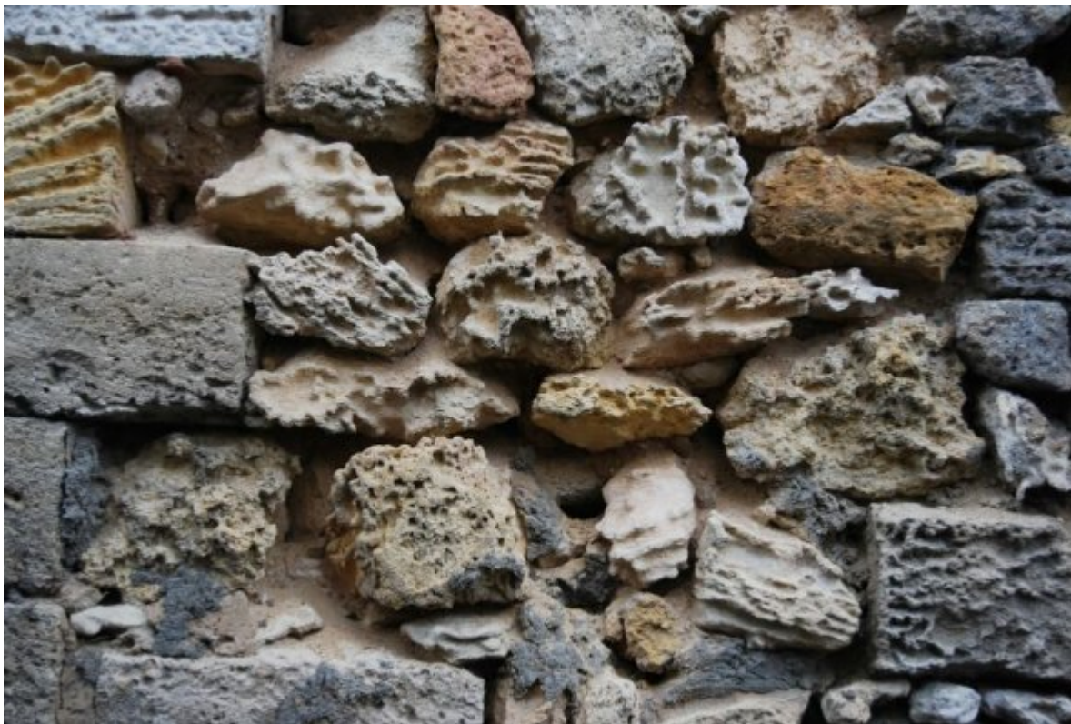
Sans la protection d'un enduit, les moellons de calcaire sont soumis à une érosion importante, Vayres crédits : Agence Folléa-Gautier
